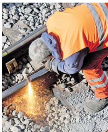
Knapp 90 Milliarden Euro könnten notwendig sein, um überfällige Sanierungen nachzuholen. FOTO: ROLAND WEIHRACH/DPA
